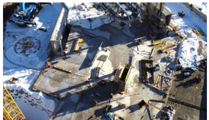
Zwischenstation der neuen Panoramabahn vor dem Einwintern Mitte Dezember 2023.
