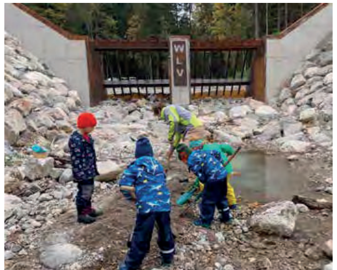
Hochwasserschutzarbeiten im Bachbett, die Volksschule Altaussee in Kooperation mit der Wildbach- und Lawinenverbauung.
