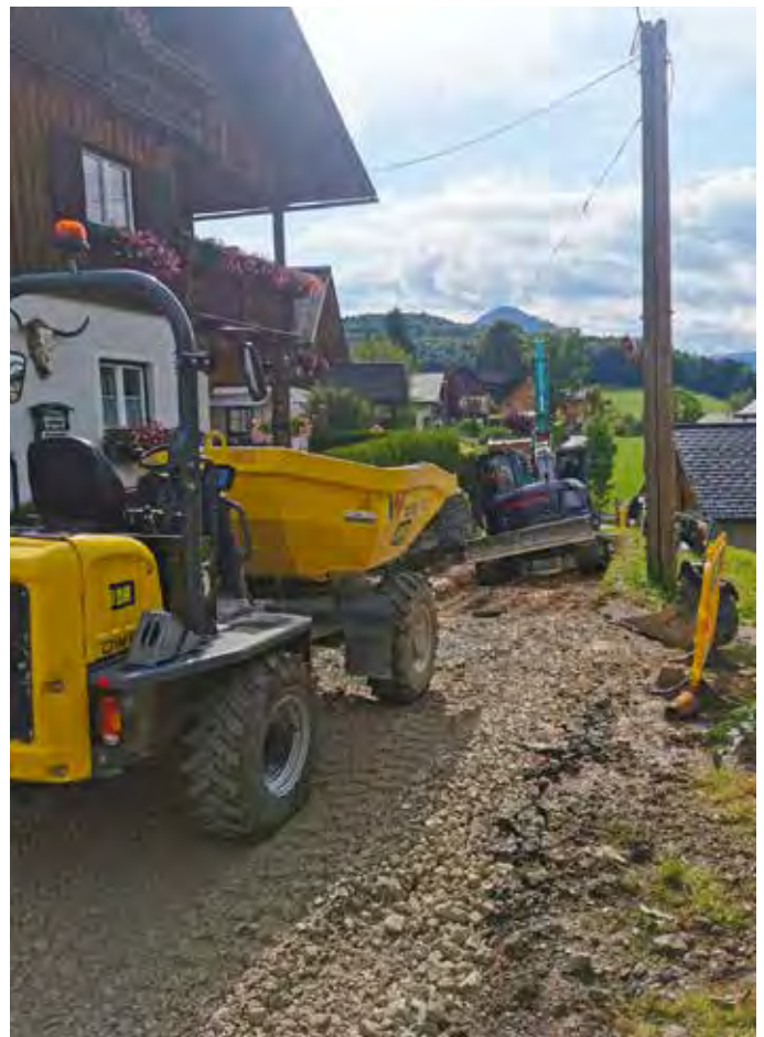
Die umfangreichen Sanierungsarbeiten an der Hodlgasse werden im Oktober mit der Asphaltierung abgeschlossen.
